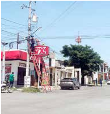
LLUVIAS PROVOCAN CAÍDAS de cables y suspensión del servicio Telmex las cuales ya fueron resueltas..
